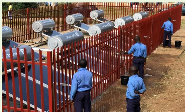
Instalação do SWH na Escola Secundária de Ciências do Governo (GSSS) em Kuru, Nigéria
