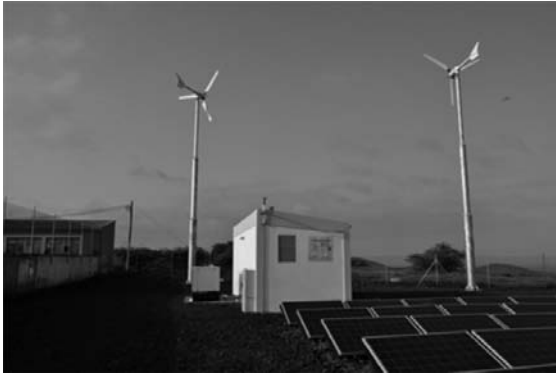
IMAGE 5. VUE PARTIELLE DE LA CENTRALE DU MICRO-RÉSEAU DE VALE DA CUSTA (SOURCE: RICAM)
