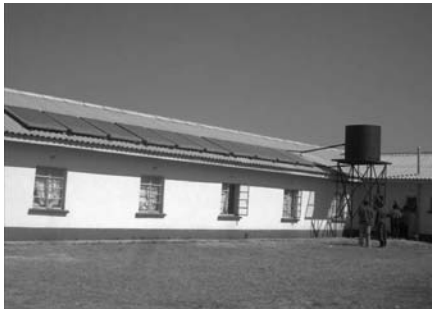
FIGURE 4. SYSTÈME À THERMOSIPHON PRODUIT LOCALEMENT POUR UN INTERNAT. ZIMBABWE
