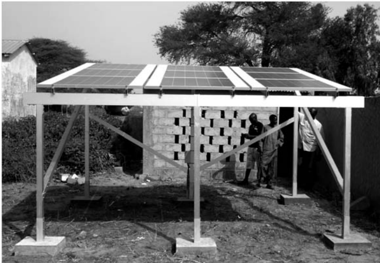
IMAGE 4. PV INSTALLATION ET LOCAL TECHNIQUE. FOURDOU
