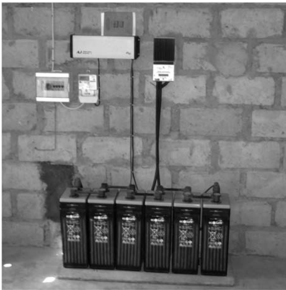
IMAGE 5. ÉQUIPEMENT À L'INTÉRIEUR DU LOCAL TECHNIQUE. FOURDOU
