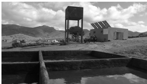
IMAGE 4. SYSTÈME D'OSMOSE INVERSE PHOTOVOLTAÏQUE INSTALLÉ À TANGARFA (MAROC) (SOURCE: ITC)
