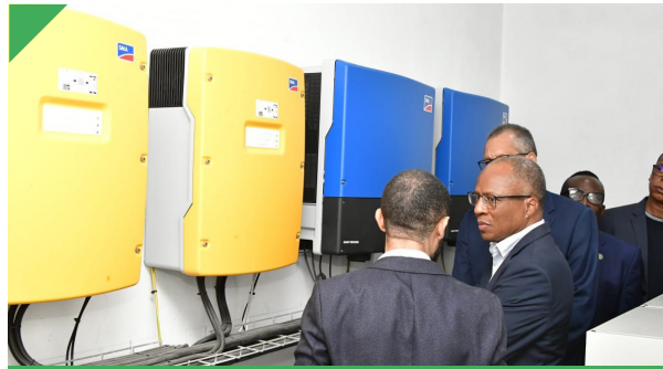
CABO VERDE (FOGO) Electrification of the Chã das Caldeiras Region
