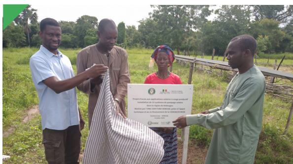
SENEGAL - 10 systèmes de pompage solaire installés à Kédougou pour un usage productif
