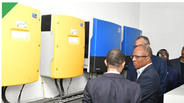
CAPO VERDE (FOGO) Électrification de la région de Chãdas Caldeiras
