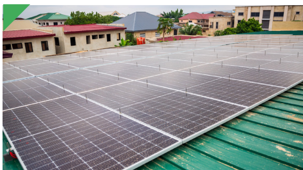
GHANA - 3 hospitais beneficiaram da instalação de energia solar fotovoltaica
