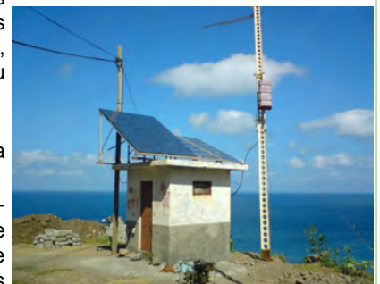
Torre de telecomunicação abastecido por PV em areas isoladas na ilha de São Nicolau
